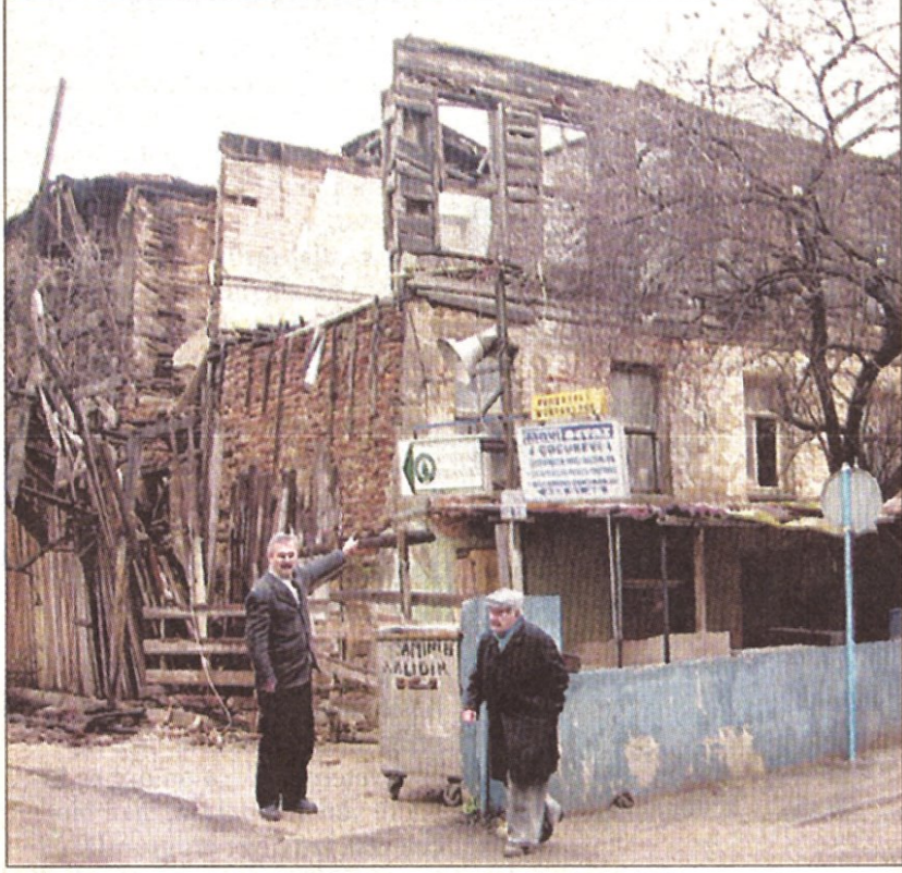
İki katlı ahşap ev, cami cemaati için de tehlike yaratıyor...
